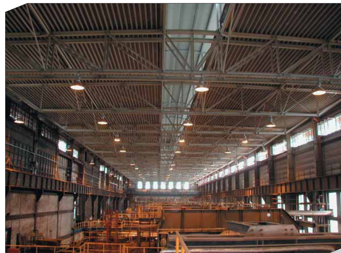
Nová ocelová konstrukce střechy kotelny New Steel Structure of the Boiler House
