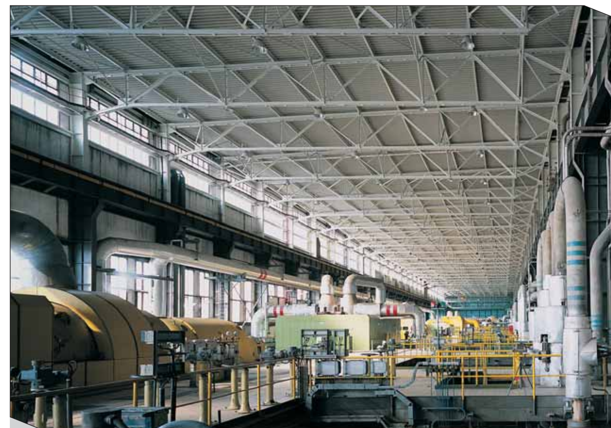
Strojovna – oprava ocelové konstrukce, výměna střešního pláště Turbine House – Reconstruction of Steel Structure, Changing of Roof Cladding
