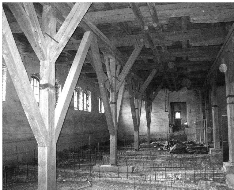
Viditelná deformace horní hrany klenebního pásu pod dodatečným dřevěným sloupem
