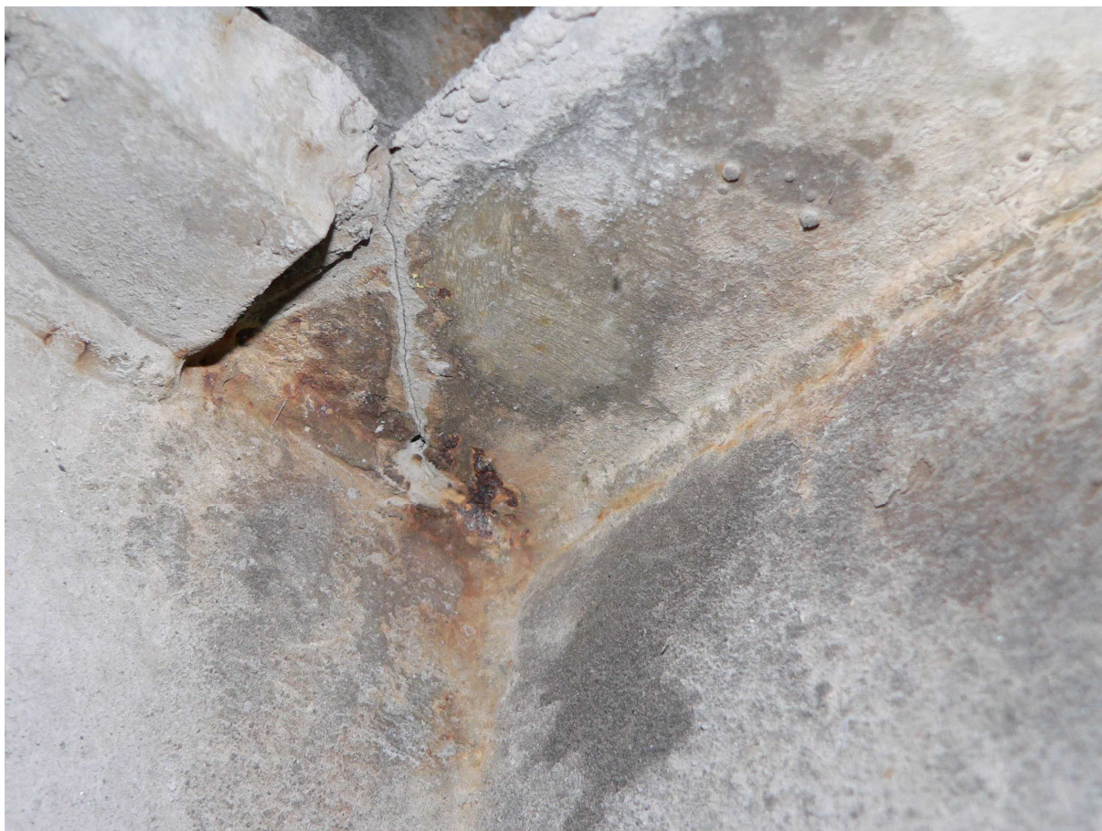
Obr. 8 Únavová trhliny vycházející z místa koncentrace napětí, dočasně sanována odvrtáním čela
