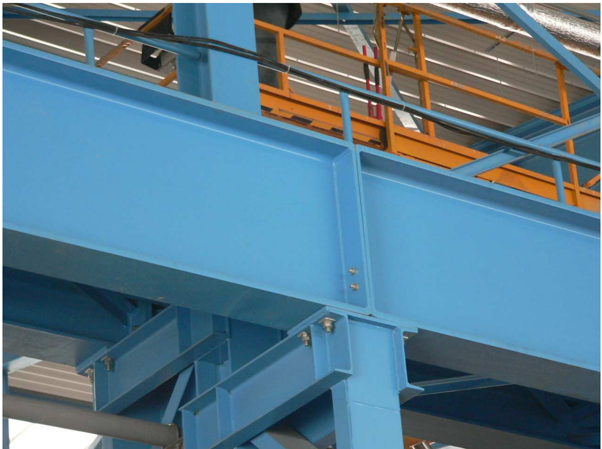
Obr. 4, Uložení jeřábové dráhy bez rektifikace
