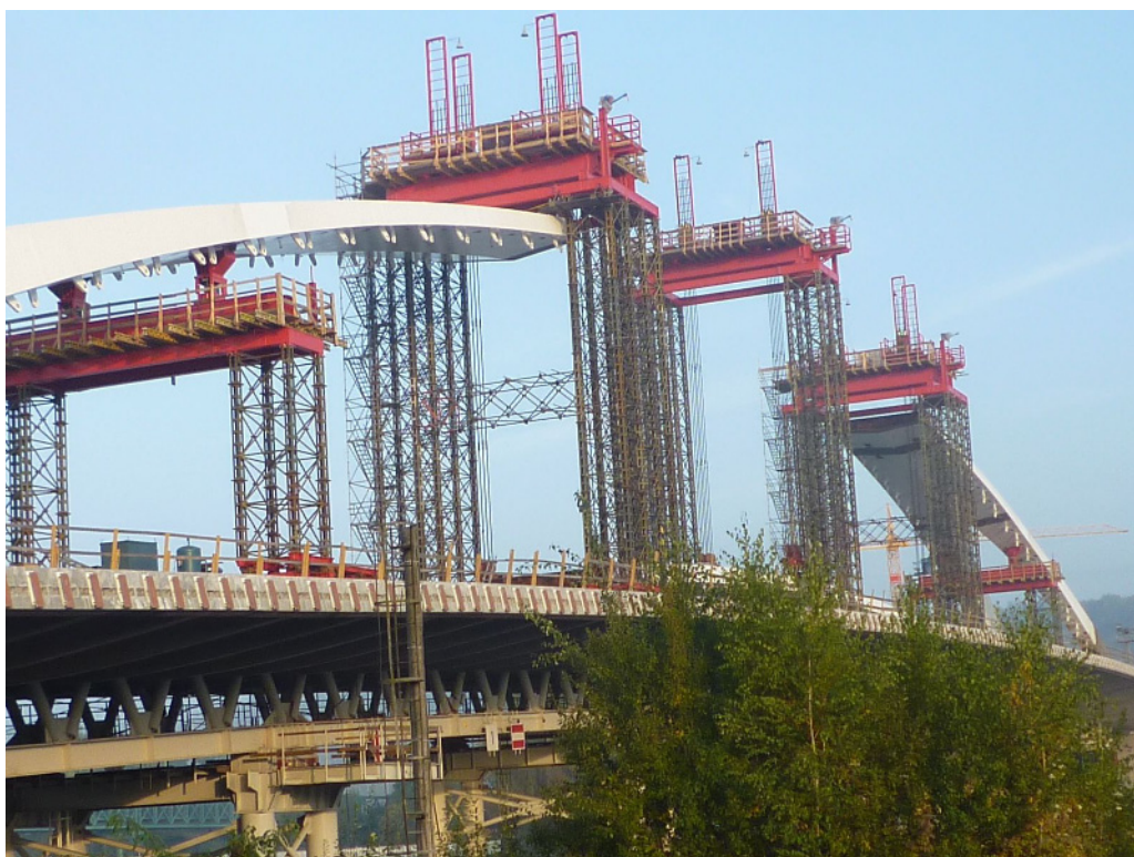
▲ Při výstavbě Trojského mostu sdílí v IS ALeX projektovou dokumentaci 20 spolupracujících týmů.
