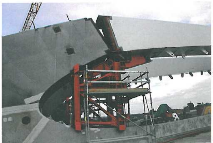
Ryc. 8b. Skrajna część łuku osadzona na sworzniu
