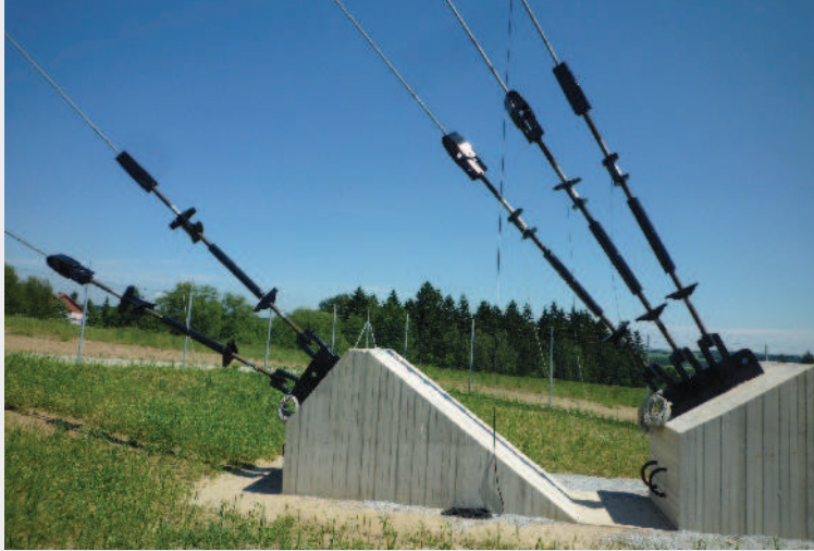
▲ Kotvení lan, napínací zařízení
