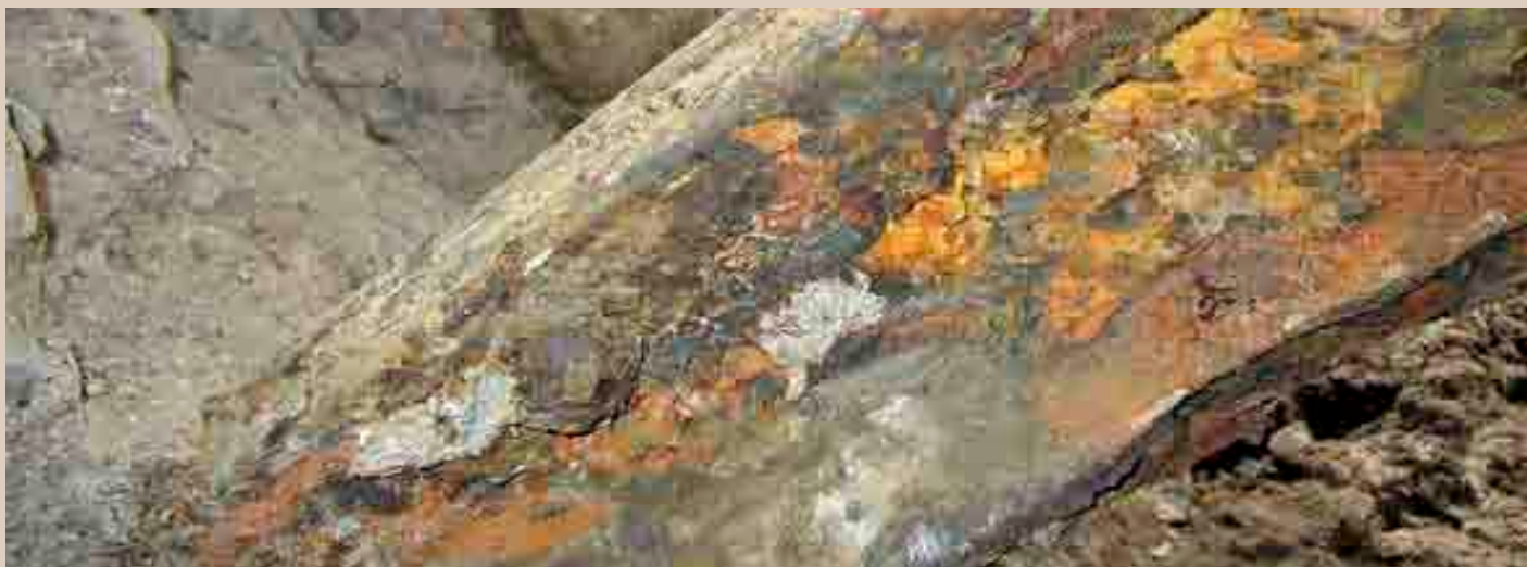
Obr. 22 Zemní táhlo 1C na IV. nástupišti po odkrytí – detail nad vstupem táhla do betonového základu. Jedná se o místo s největším korozním poškozením, cca 70 %
