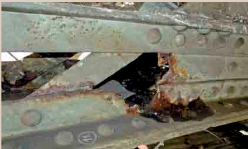
Obr. 6 Korozní poškození spodního pasu příčné vazby – vazba 21 A-B
