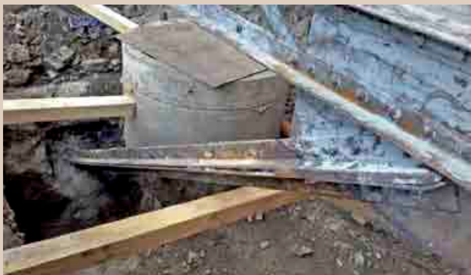
Obr. 21 Zemní táhlo 1C na IV. nástupišti po odkrytí – stav před výměnou
