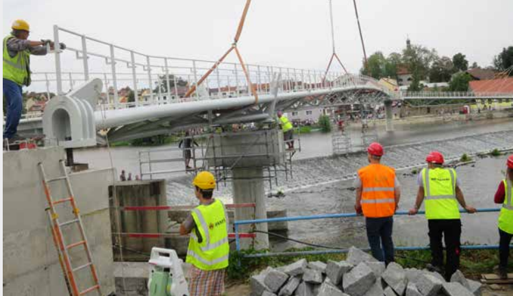
▲ Obr. 14 Montáž tělesa lávky na opěru pilíře a montážní podporu v řece
