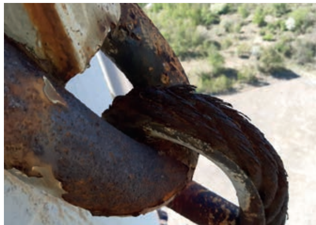
Obr. 4 – Koroze kotevního lana
