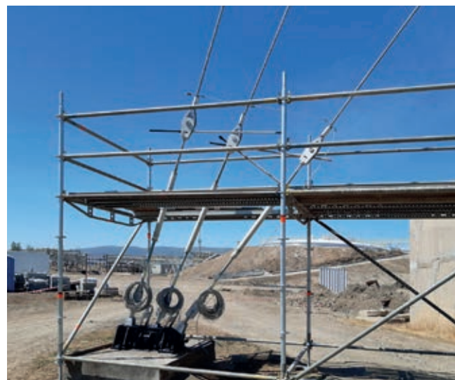
Obr. 9 – Napínací zařízení, tenzometry s kabely na dolních tyčích zařízení
