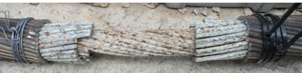
▲ Obr. 4 Korozní stav vnitřních drátů lana po 37 letech provozu (foto: Milan Dzurčanin)
